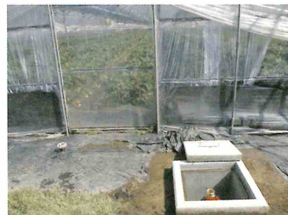
平成17年度に設置された給水栓(ハウススイッチ)
