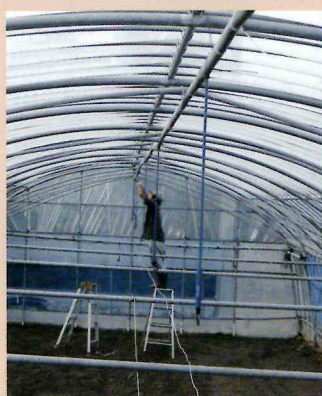
散水施設の導入状況
