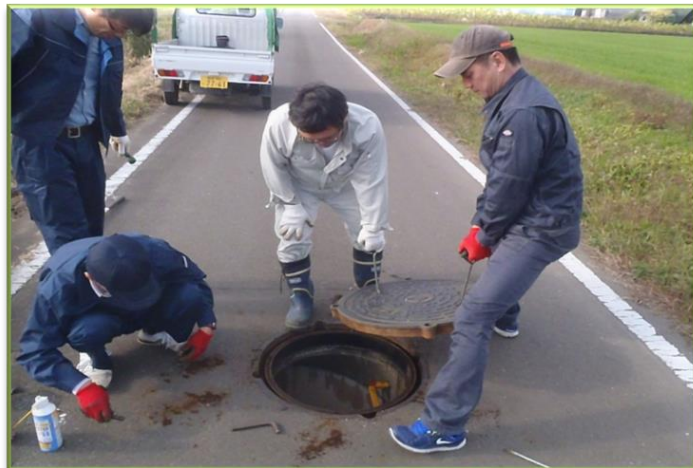
パイプラインの点検管理
