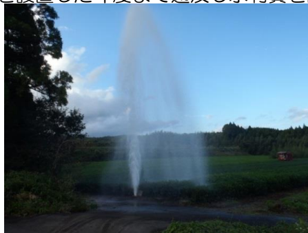
【写真2】給水栓破損による漏水
